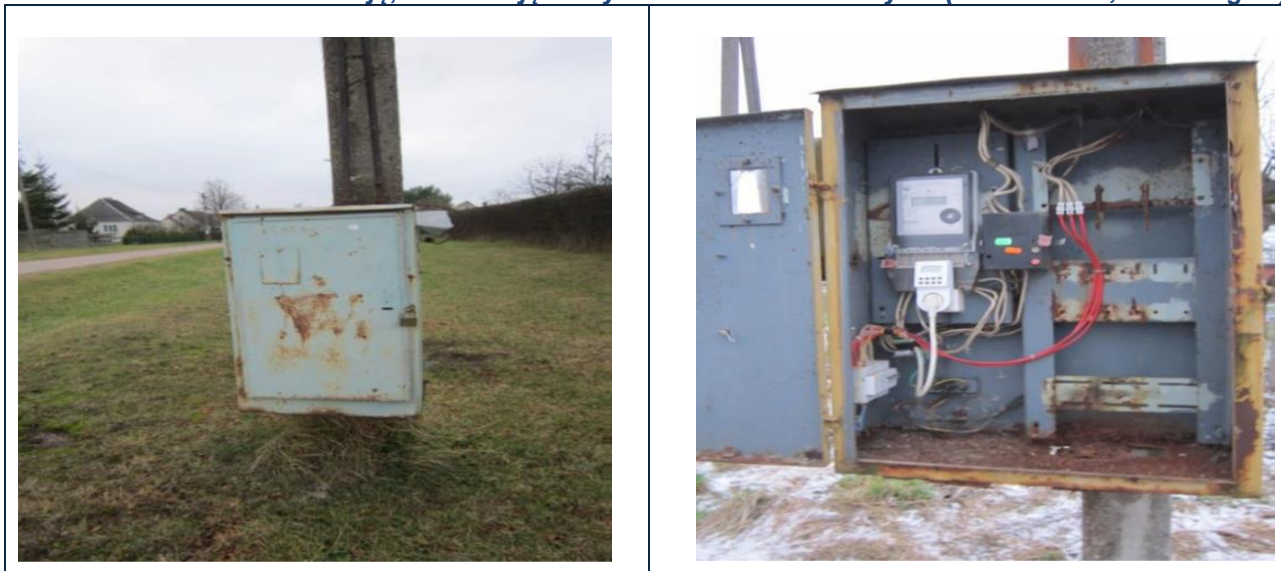
Pav. 7. Surūdiję, susidėvėję valdymo ir automatikos skydai (Taurakiemis, Vandžiogala)
